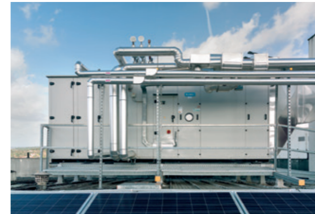
Figur 25: Exempel på en installation utomhus
